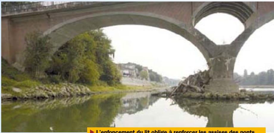
► L'enfoncement du lit oblige à renforcer les assises des ponts.
